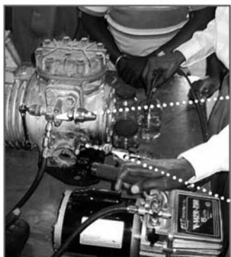
Figura 6. Processo di riempimento dell'olio (in dettaglio).
